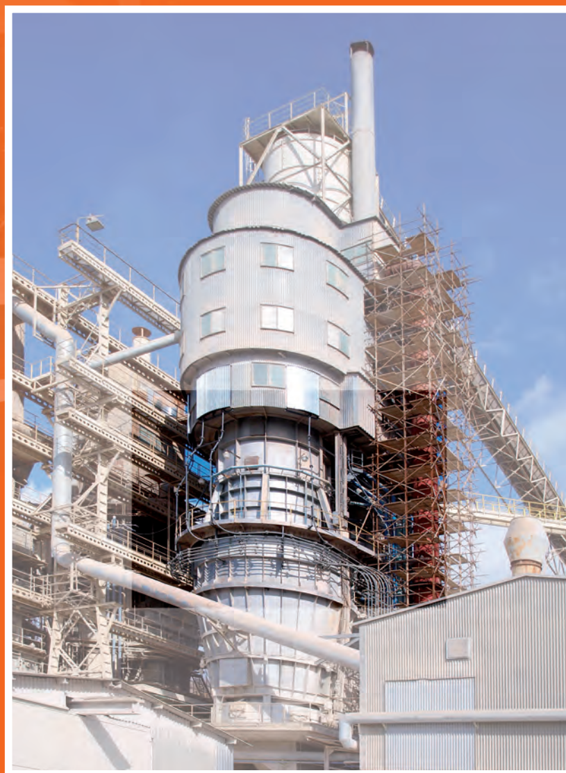
Celkový pohled pece Maerz
