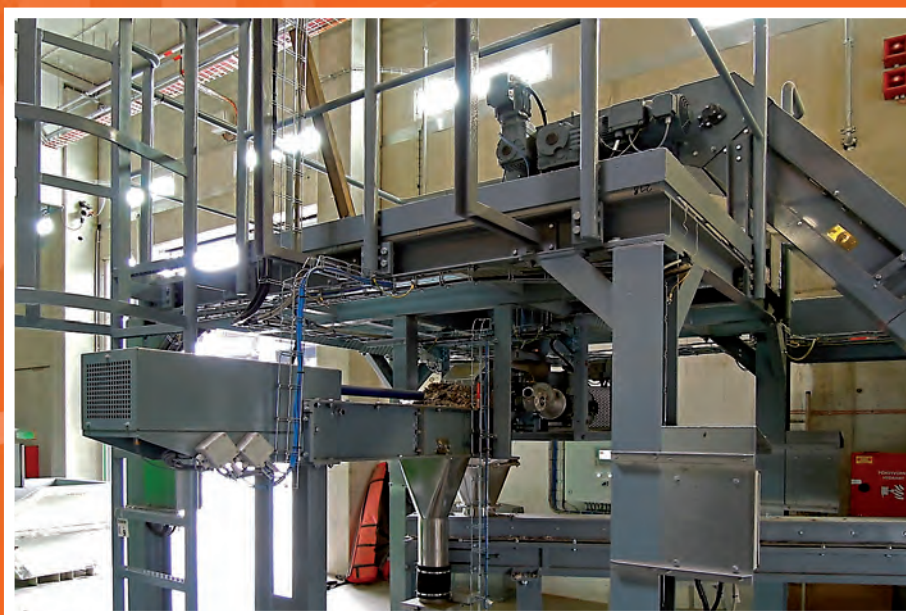
Nově instalovaná vzorkovací stanice TAP - dělicí soustava pod homogenizátorem
