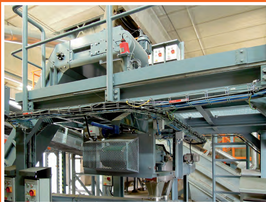
Nově instalovaná vzorkovací stanice TAP - výpad šikmého pásu do homogenizátoru
